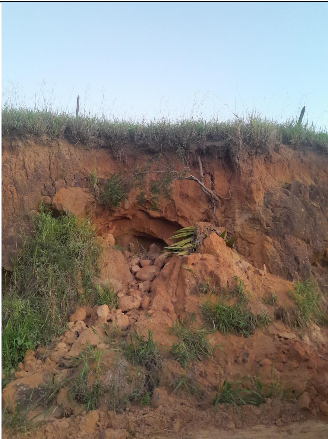
Figura 50. Erosão em corte de estrada no Município de Pirai
